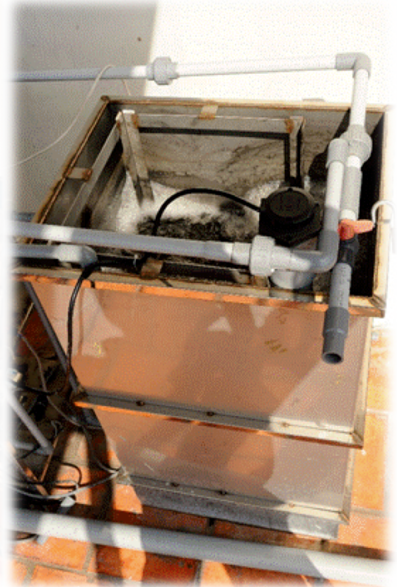
UF membrane tank of 185 l
